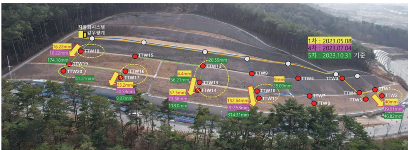
사진4. 2차 붕괴시 지표변위복합센서 위치별 이상 변위발생 계측 자료
