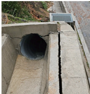
측구 파손 및 이격
