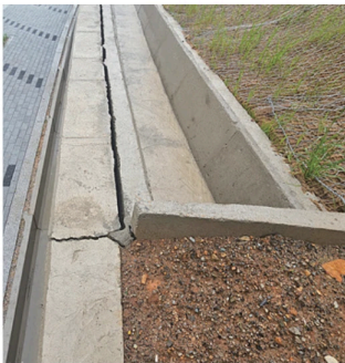
옹벽 균열 및 이격
