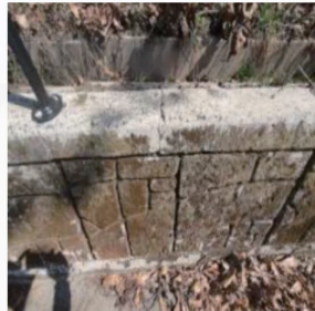
(측구 균열 및 파손 발생)
